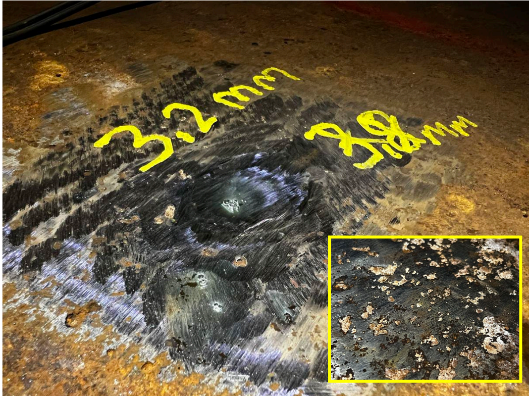
Mynd 5 og 6. Yfirborð platna er yfirleitt pyttað. Slípað var í verstu pyttina og mælt með þykktarmæli.
