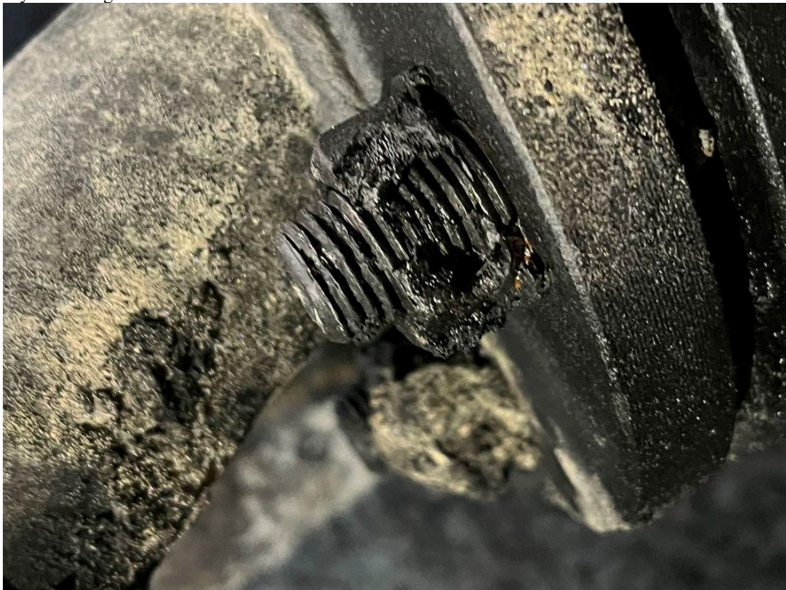
Mynd 6. Rær voru tærðar á flönsum. Þeim var skipt út.
