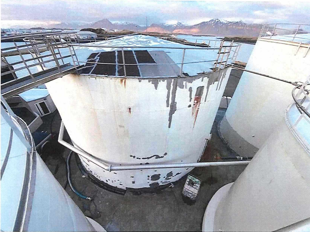
Mynd 5. Þak geymis er ónýtt og verður lagfært.
