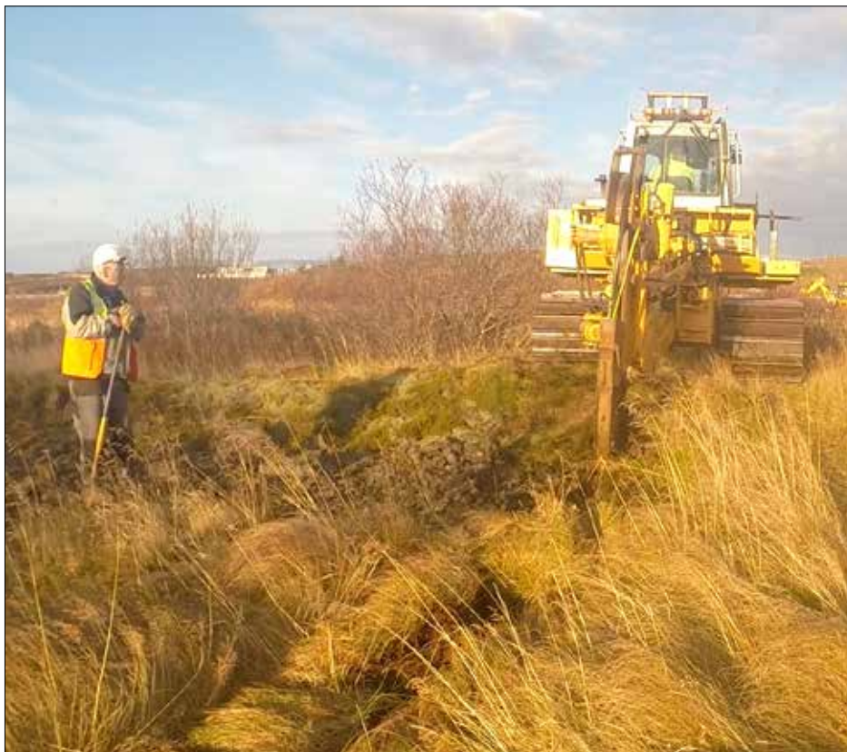
Mynd 8. Elliðavatnslína lögð í jörð á haustdögum 2014. Þess var gætt að nýta tækni og verklag til að draga úr raski meðal annars á grónu landi. Ljósmynd: Ingvar Jón Ingvarsson.
