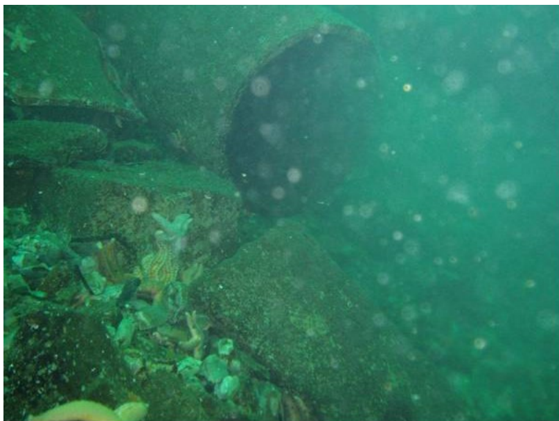
Figur 3 Utløp vestre avløp, 11 meters dyp
